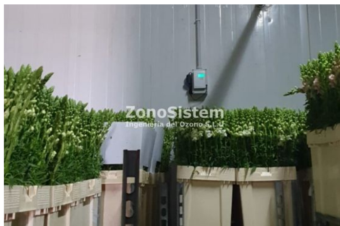
Ozônio em armazenamento refrigerado para flores cortadas em Chipiona, Espanha.
